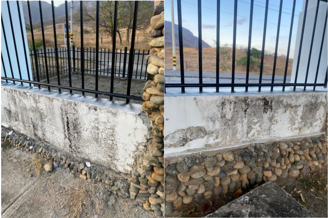
Figura 12. Imagen de patologías, humedad y desprendimiento. Imagen propia
